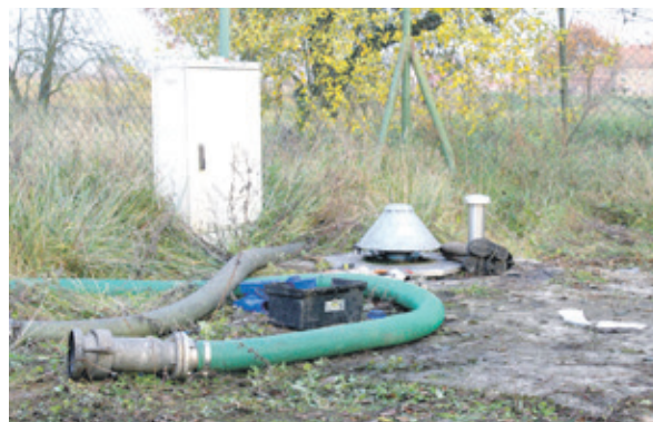
Do wypadku przy pracy doszło 2 listopada 2011 roku w przepompowni ścieków w Zimnej Wodzie
