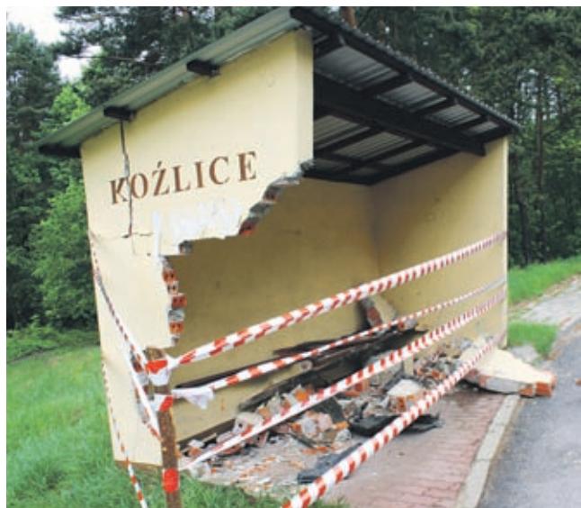
Kierowca uderzył w betonową ścianę przystanku
