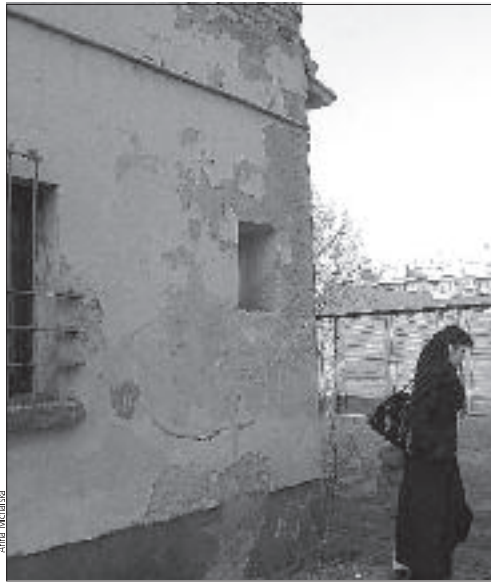
Odpadający tynk z obiektu na rogu ulic Słonecznej i Śląskiej może stanowić zagrożenie dla przechodniów
